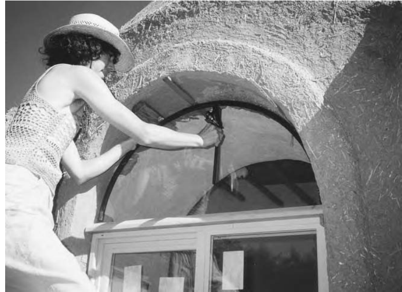
8.8 (stânga): Montați panoul semirotund de sticlă deasupra opritorului, care a fost montat anterior deasupra ferestrei de vinil. Verificați verticalitatea și asigurați cu pene.
