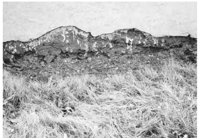
4.11 (sus): Tencuind jos, la nivelul pământului, riscați să atrageți umezeala în pereți, provocând exfoliere și alte pagube datorate umidității.
