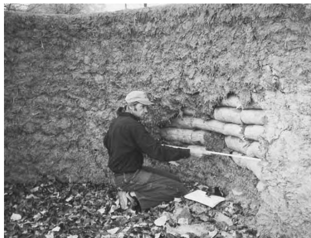
2.11a: Proprietarii acestui zid despărțitor în apropierea unei intersecții aglomerate din oraș au descoperit că o secțiune a tencuiei a căzuse. Motivul este prezentat în poza următoare.
