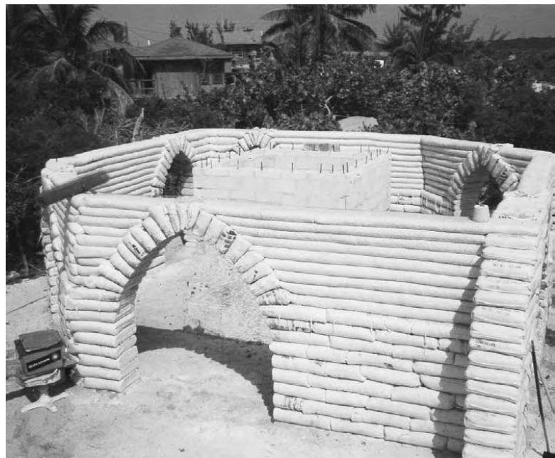
2.13: Sacii de 50 kg și cei mult prea mari pot fi, de asemenea, folosiți pentru cadrele ușilor și ale ferestrelor, în combinație cu sacii/tuburile de 25 kg folosite la ziduri.
