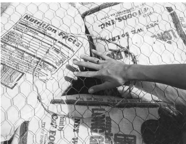
12.32: Un cerc de sârmă ghimpată ține sacii împreună, în timp ce plasa de sârmă oferă o suprafață ușor de apucat pentru aplicarea ulterioară a tencuiei.
