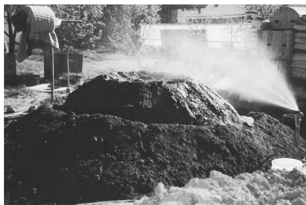
2.8: Pregătirea materialului pentru construcția zidului, prin folosirea unui furtun pentru a pre-umezi o grămadă de pământ.
