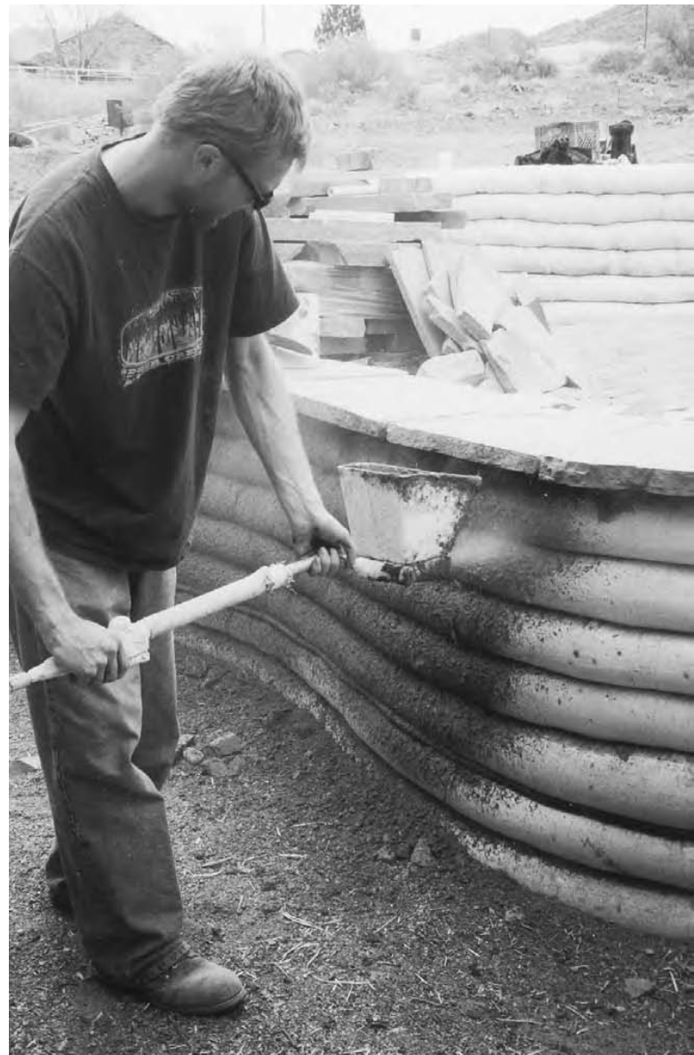
14.9: Pulverizarea nămolului pe un perete din saci cu pământ cu ajutorul unui pulverizator de tencuială.
