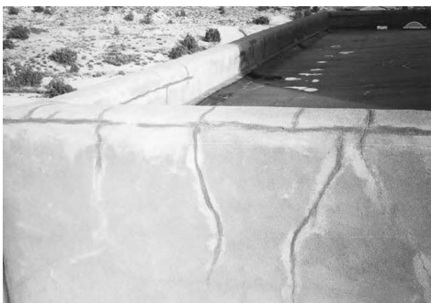
14.19: Până și tencuiala din ciment de pe chirpiciul stabilizat al acestei case moderne construită în stil sud-vestic s-a crăpat.
